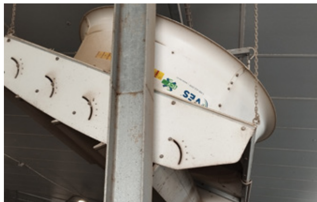
Nagy teljesítményű lamellás ventilátorok – hűtsünk a Nap energiájával! (2024.01.29. Somogyiszob, Orosz)
