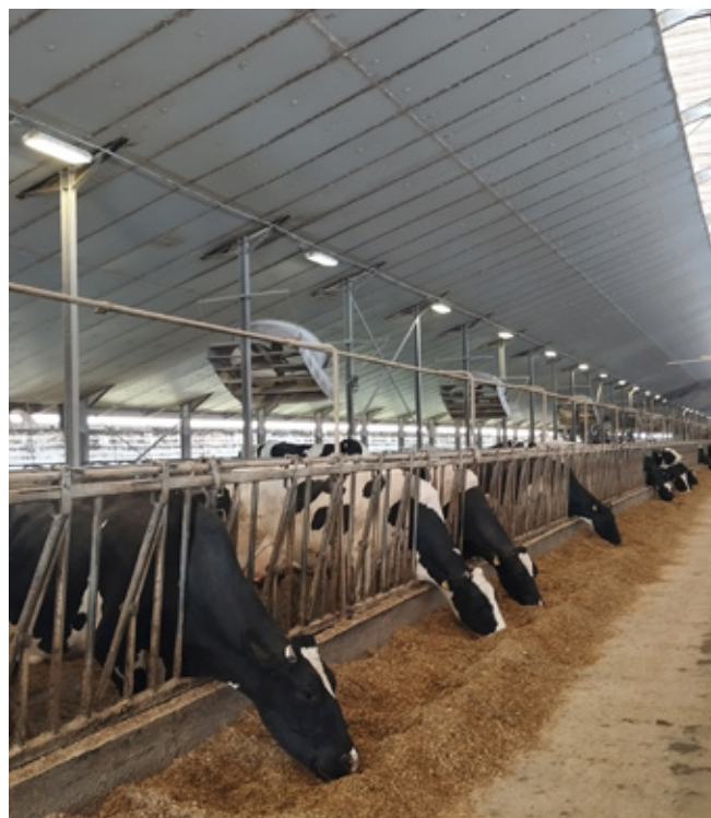
Régi, nyitott istállóban elhelyezett frekvenciaváltós lamellás ventilátorok Somogyszobon (2024. 01.29. Orosz)
