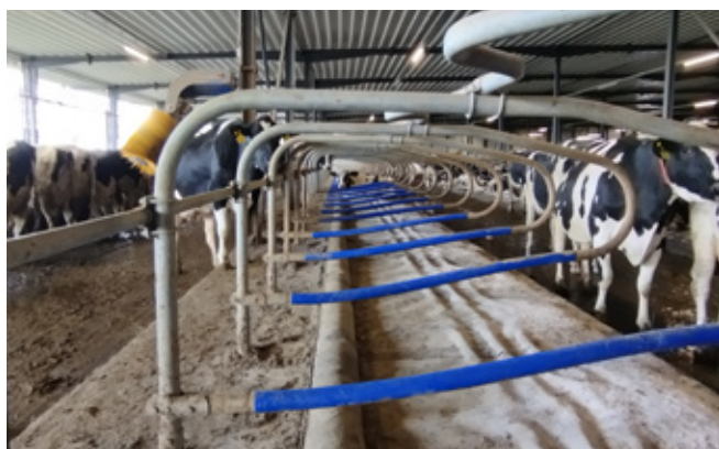
A hűtött vízágy továbbfejlesztett változat, és még jobban segíti nyáron a tehén pihenését a boxban: a vízágy belsejében lévő 3 csőben hideg víz áramoltatható (2024.04.03. Kisdombegyháza, Orosz).
